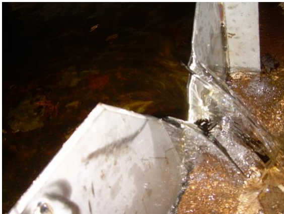
Figur 15: V-overløp (Foto: Norconsult)
