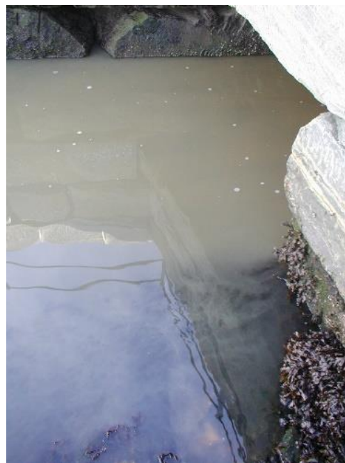
Figur 1: Spillvannspåvirket bekk i kulvert ved utløp til sjø. Foto: Norconsult
