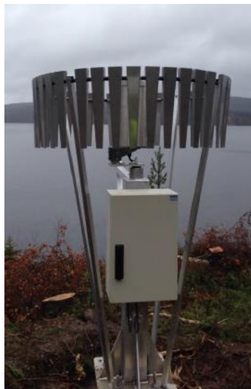
Figur 13: Eksempel på installert permanent nedbørmåler med vindskjerm (foto: Scanmatic)
