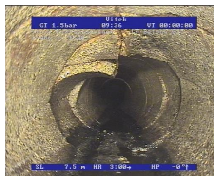
Figur 14: Rørinspeksjon der utett rør avdekkes. (Foto: Stord kommune/Vitek)
