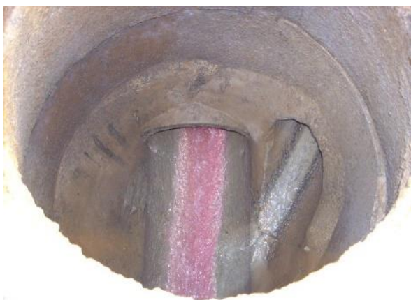
Figur 6: Rhodamin tilsatt i SP-ledning, gjenfunnet i OV-nett nedstrøms. Foto: Norconsult
