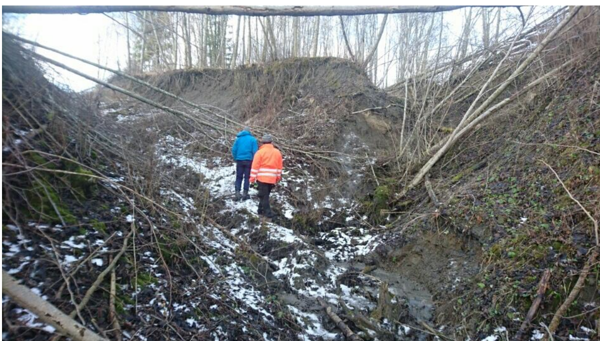
Foto I. Utløp nederst i dråg fra ugrøftet planering, uten kummer for overflatevann. 80 daa drenerer til dette punktet. Det har gradvis gravd og rast ut mer og eskalert siden 2011. Her ble det utarbeidet SMIL-søknad, se foto II.
